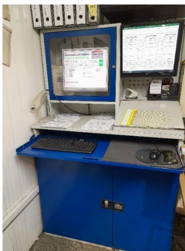
PC de control integrado en su cabina de protección
