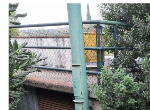
Malla de simple torsió deteriorada
