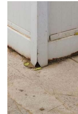
Perfil inferior deteriorat
