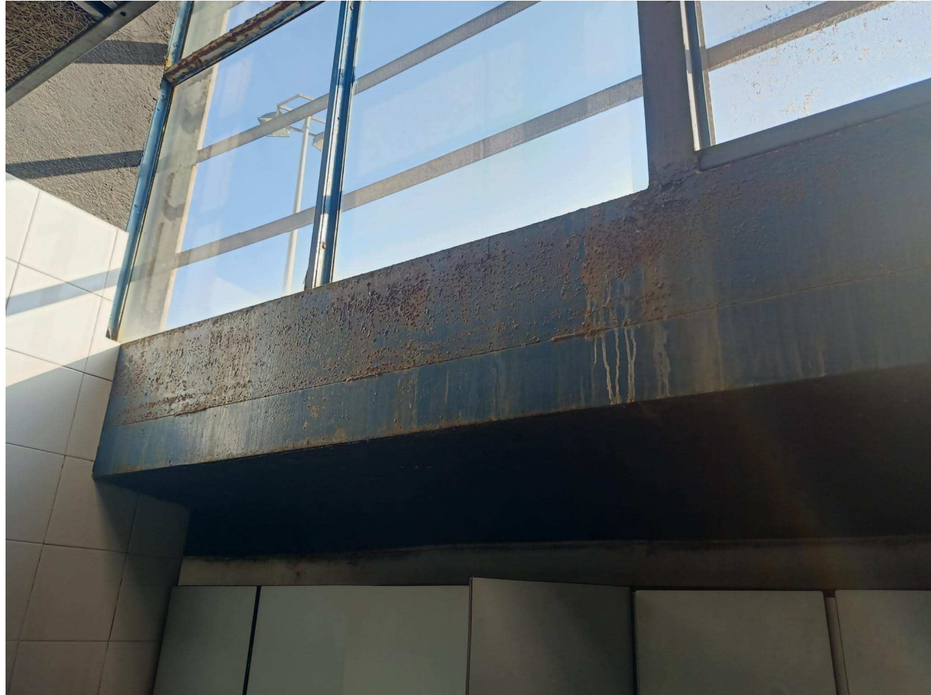
Detalles de corrosión en la zona de vestuarios
