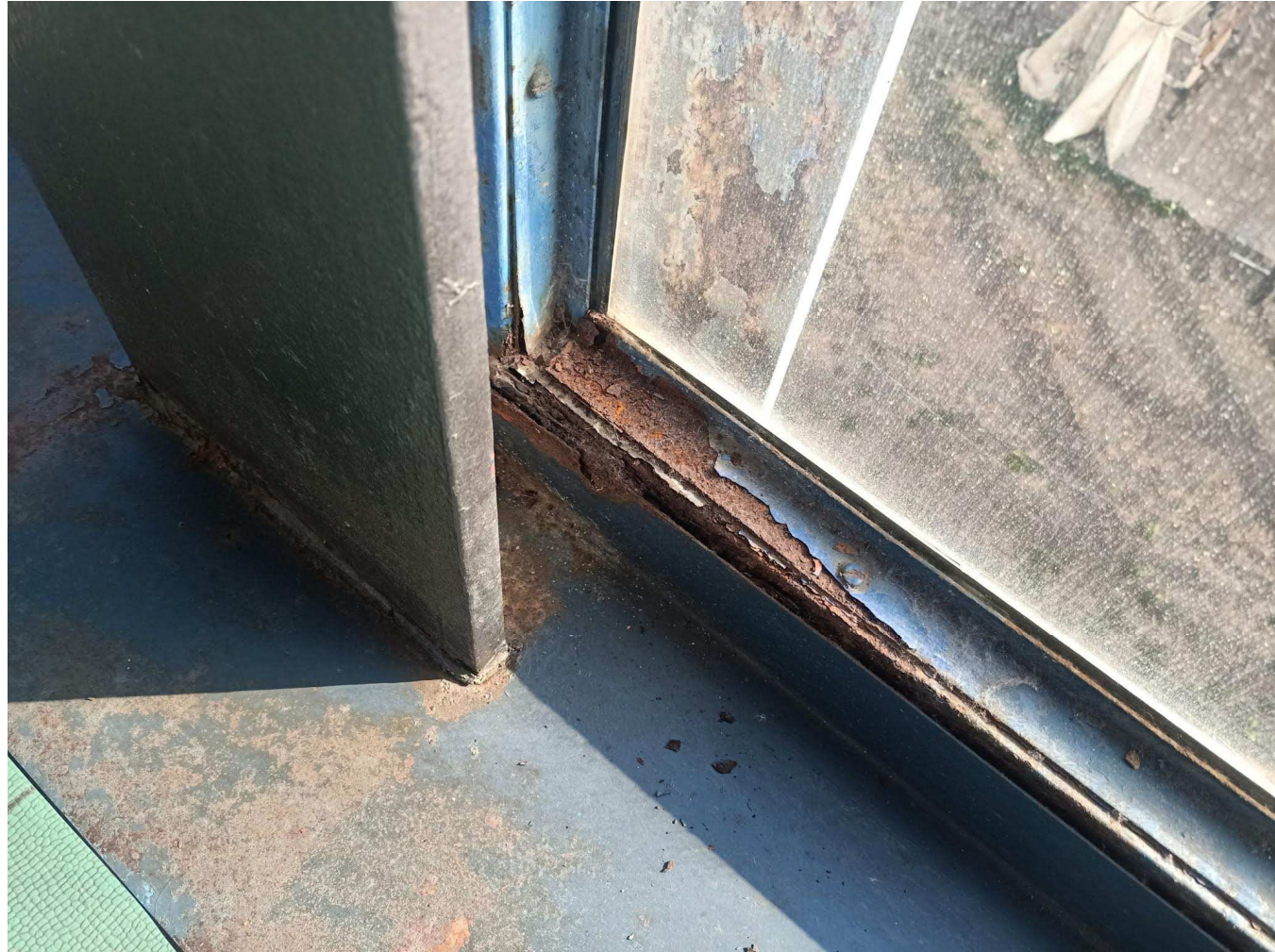
Detalles de corrosión en los junquillos por el interior
