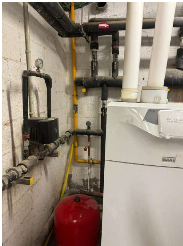
Caldera i bomba circuladora de primari
