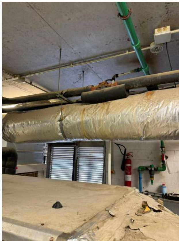
Distribució hidràulica amb valvuleria oxidada i desperfectes a l'aïllament.
