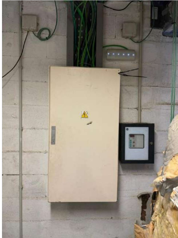
Quadre elèctric i de control de sala de calderes.
