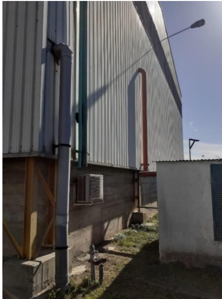
Imagen 1: Tubería de PCI existente (tubería roja a pintar, 6")
