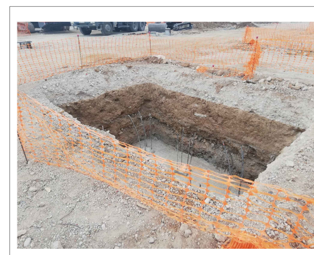
A TENER EN CUENTA 1,5 MTS DE DISTANCIA DESDE LA RED DE PROTECCION HASTA EL BORDE DE LA EXCAVACION
