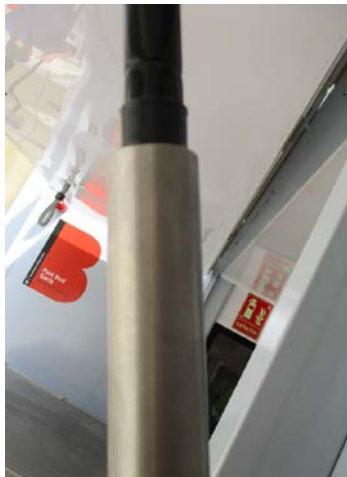
Imatge dels amortidors actuals, instal·lats a les portes.
