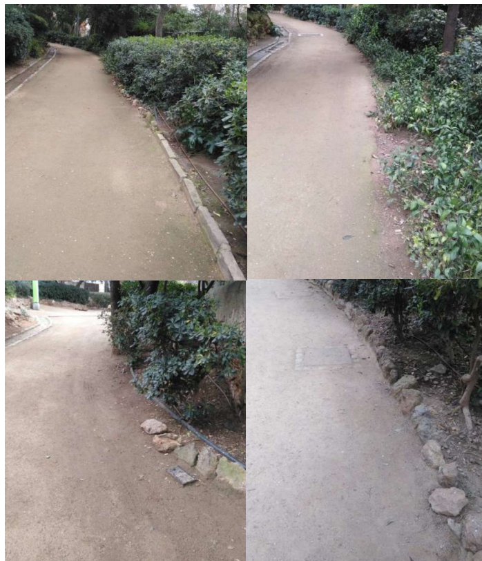
Figura 4. Encintat de pedra que caldria refer com a millores en el parterre lateral del parc de Monterols entrant per les escales de Gualbes.
