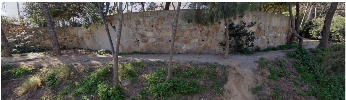
Zona 2: mur colindant al portal d'accés a finca costat baixada c. Desert de Sarrià.
