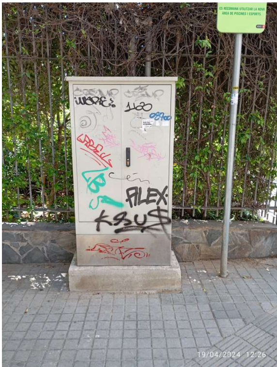
Foto 1 Exterior armari Instal·lat
