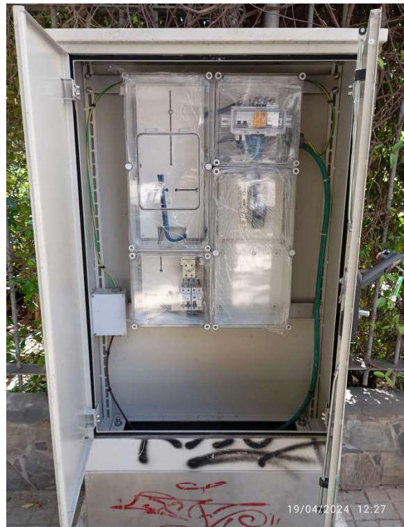
Foto 2 Interior armari Instal·lat
