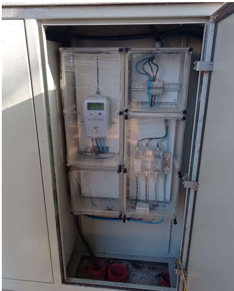
Foto 2 Interior de l'armari existent ( situat al costat de la caseta dels Jardiners)
