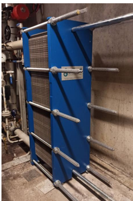
Bescanviador de calor
