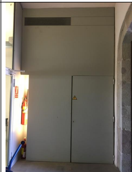
Foto cancell d'entrada. Sala 4 Oficines. Armari d'instal·lació
