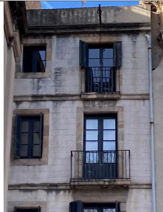
Balconera A 3 -A 4 i finestra B 3 -B 4 . Tercera i quarta planta. Façana principal. Vista exterior
