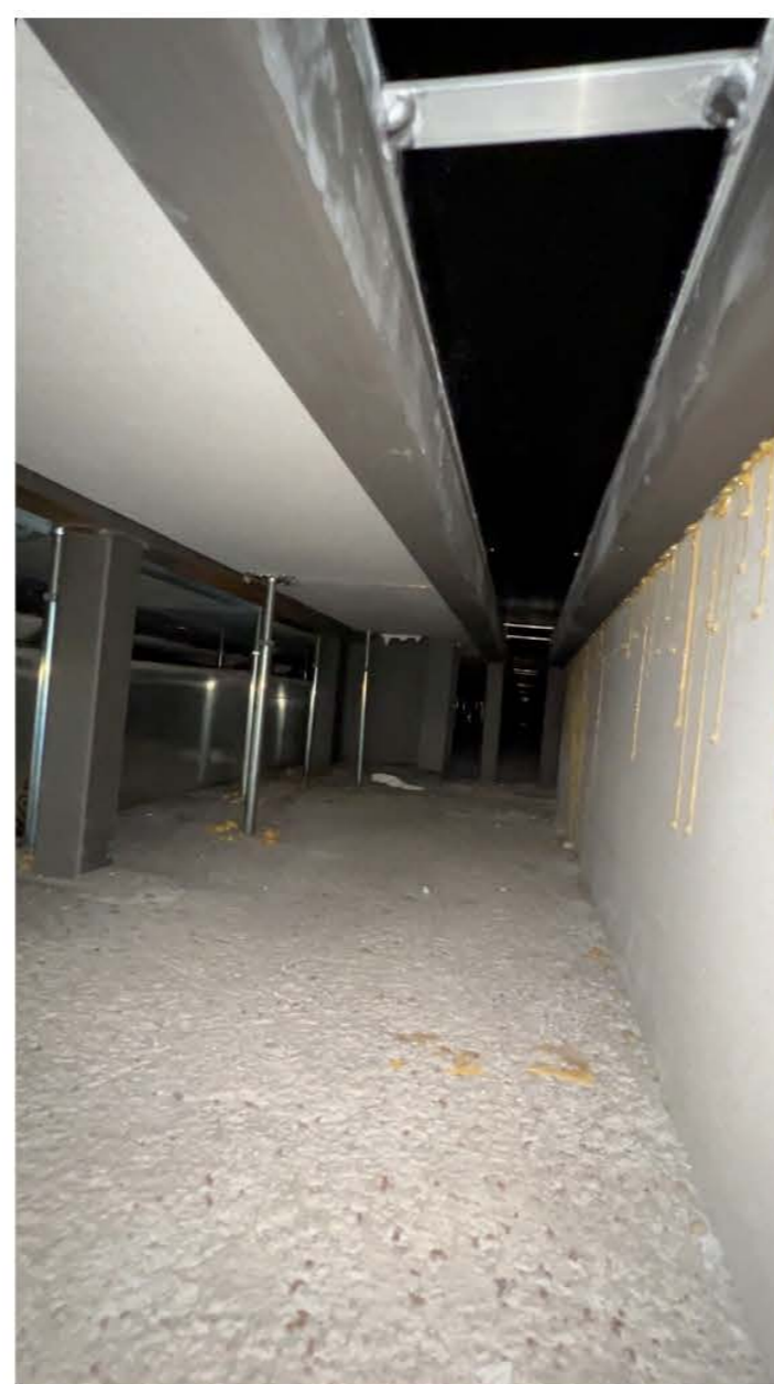
També podem veure els recolzaments a base de plaques i estructures que suporten el paviment tècnic.
