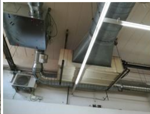
Màquines en sostre mercat
