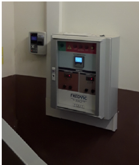
Quadre i controlador de fred a traslladar
