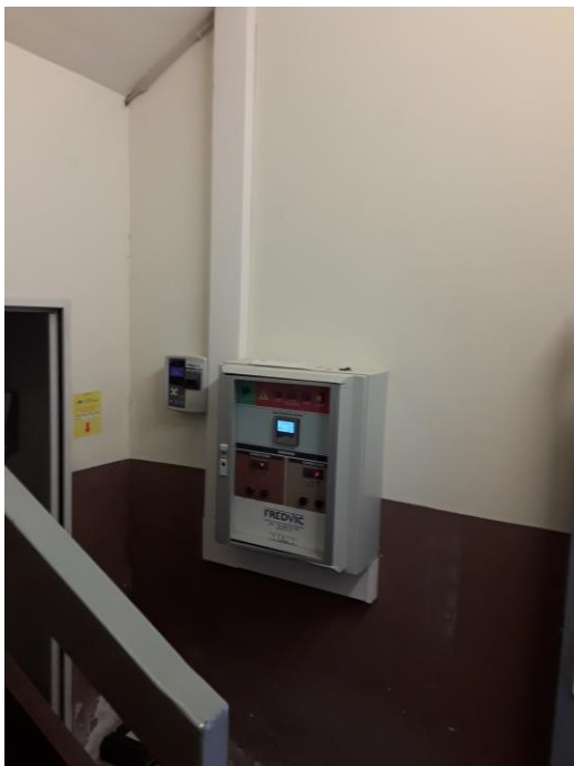
Quadre fred i control temperatura a desplaçar
