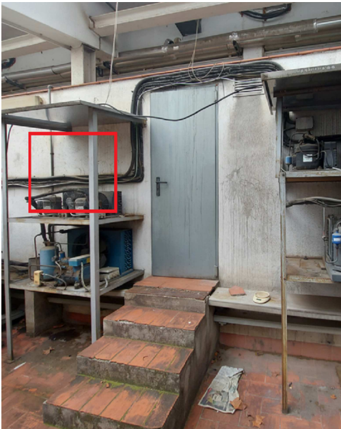
SITUACIÓ UNITAT EXTERIOR CLIMA
