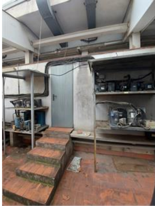
Màquines del local en la coberta
