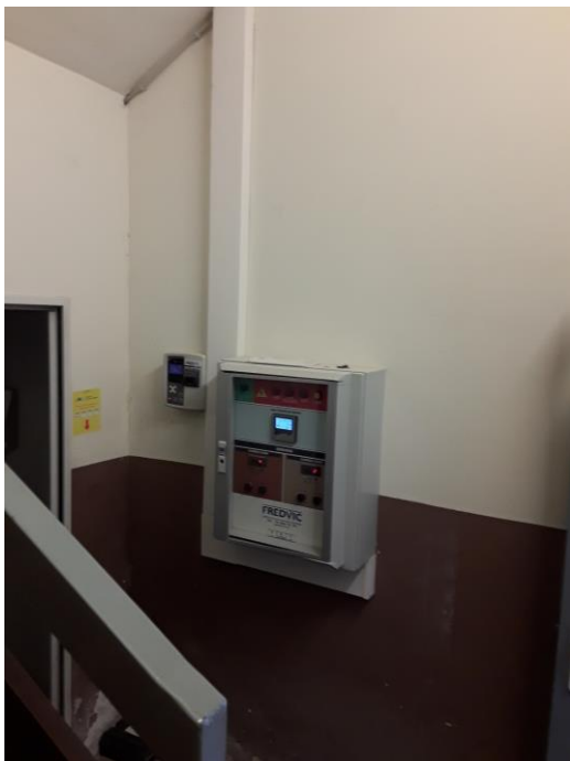
Quadre fred i control temperatura a desplaçar
