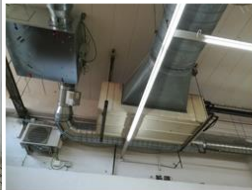
Màquines en sostre mercat
