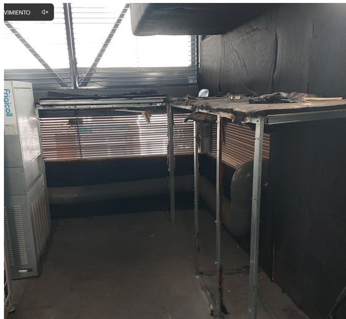
Vista interior sala màquines
