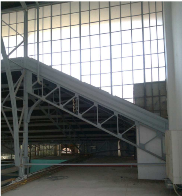
Vista zona sortida i entrada d'aire campana
