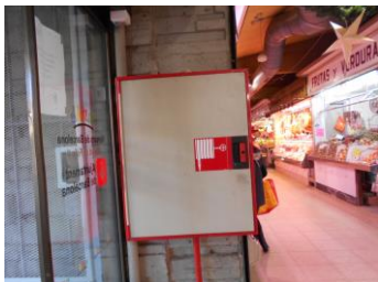
Fig. 46 i 47 ubicació de mànegues i extintors.
