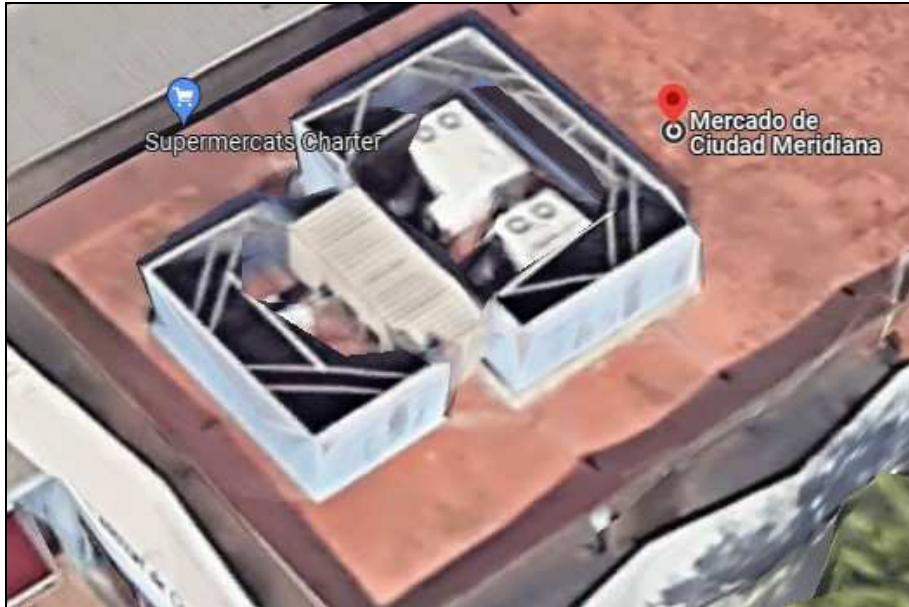
Unitats de clima roof-tops en recinte acústic
